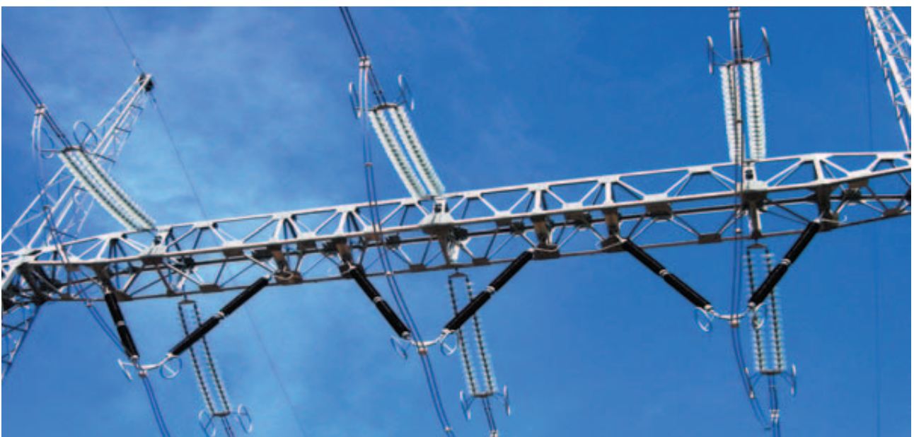
Red eléctrica de alta tensión
